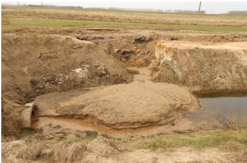
Рис. 3.3. Разрушение откоса канала сосредоточенным стоком.
