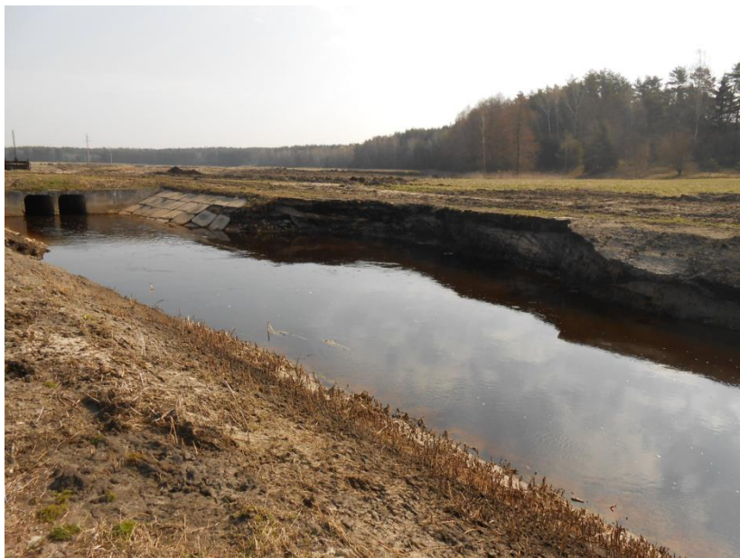
Рис. 3.1. Обрушение откоса канала.
