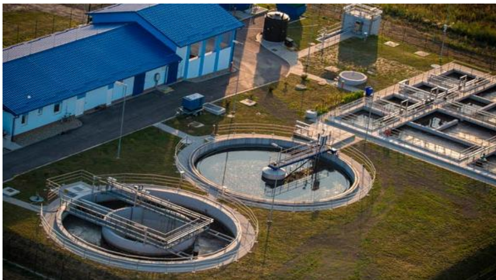
Рис. 34. Современная очистная станция
