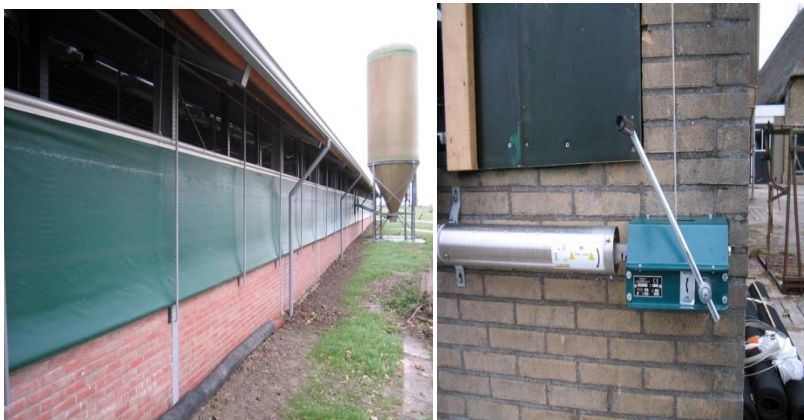
Рис. 17. Шторная система вентиляции в коровнике с автоматическим управлением
