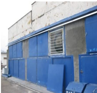
Рис. 14. Вытяжные вентиляторы в заднем торце помещения
