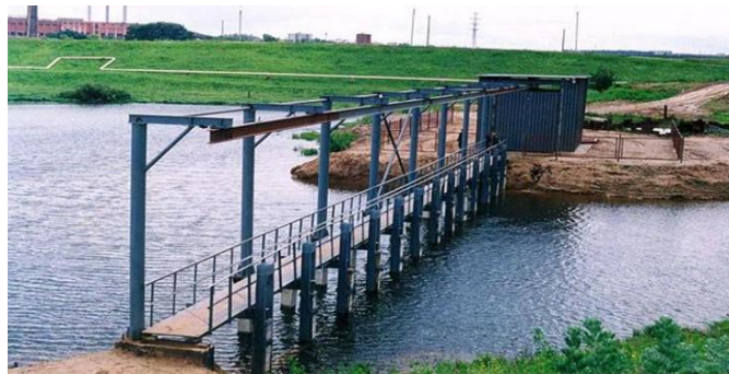
Рис. 7.2.13. Рыбозащитные сооружения насосной станции Костромской низины
