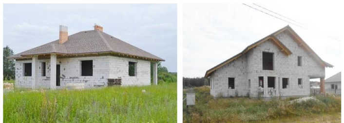
Рис. 9.3. Незавершенное законсервированное капитальное строение
