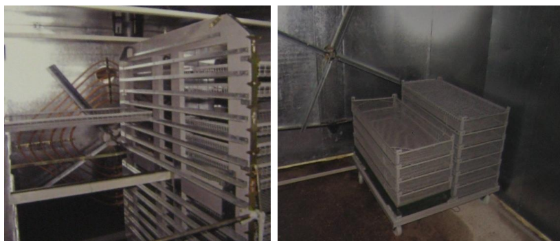
Рис. 1.19. Системы охлаждения и увлажнения ИУП-Ф-45 (слева) и ИУВ-Ф-15 (справа)
