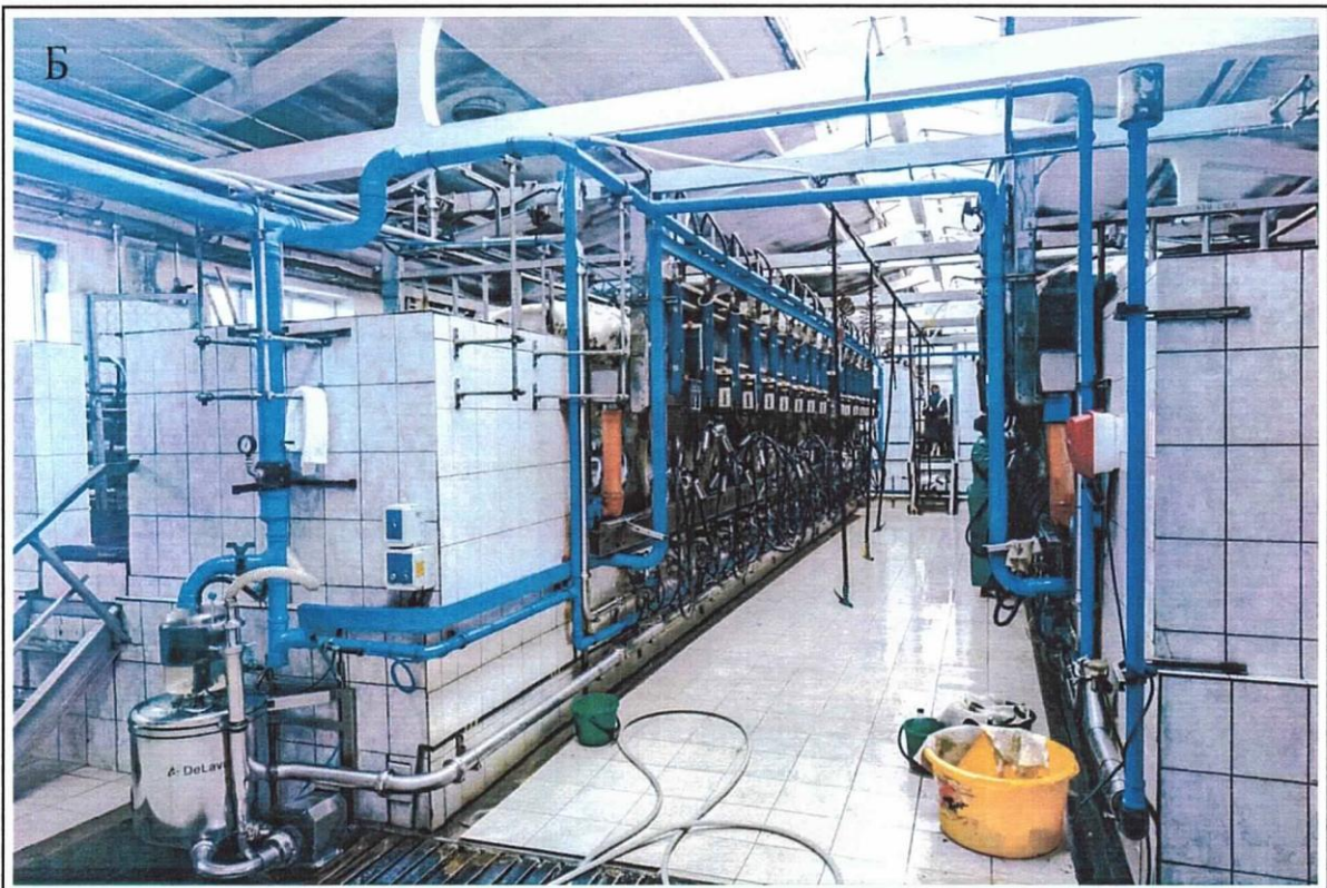
Рисунок 6.5 – Интерьеры основных помещений молочной фермы агрогородка Тихиничи Рогачевского района: А – здание для содержания животных; Б – молочный блок
