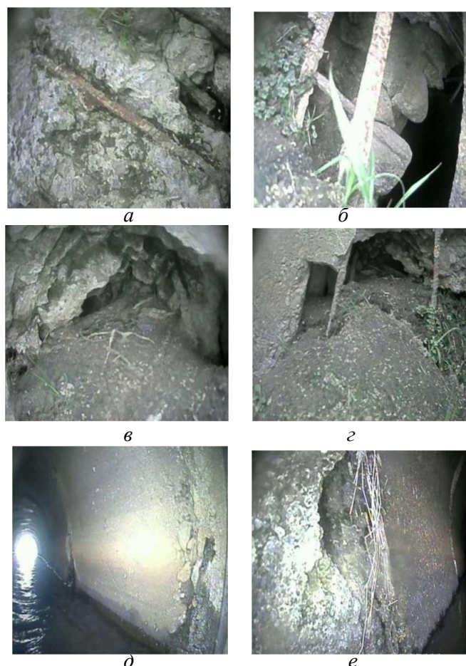
Рисунок 3– Визуальная оценка повреждений труб-регуляторов посредством фотофиксации КСД-160У: а, б - локальное и площадное обнажение арматуры оголовка; в, г – разрушение бетонной части оголовка с выпором грунта обнажением арматуры; д, е – разрушение стенок труб в месте стыков и примыкания к оголовку
