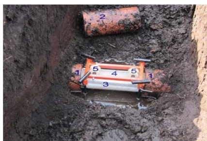
Рисунок 7 – Установка муфты промывочной МПГ-1: 1 - трубки дренажного коллектора, между которыми устанавливается муфта промывочная; 2 - снятая дренажная трубка, вместо которой устанавливается муфта промывочная; 3 - корпус муфты промывочной; 4 - полость муфты промывочной; 5 - направляющие ролики стеклопластикового стержня устройства ОД-100.
