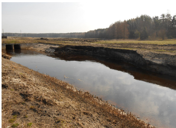
Рис. 3.1. Обрушение откоса канала
