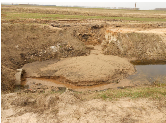
Рис. 3.3. Разрушение откоса канала сосредоточенным стоком
